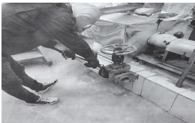
關閉泵進出口閥門
