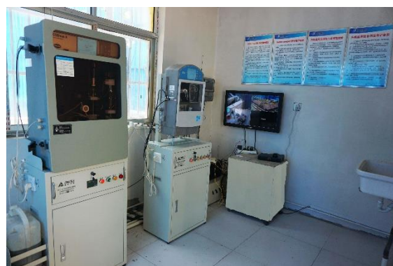
廢水線上監測系統
