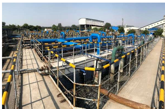
中峰化學污水處理
